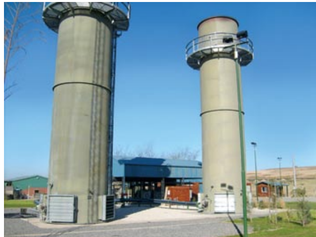
Ecoayres; extracción de biogás.
